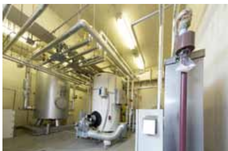
▲ボイラ・貯湯槽室の全景
