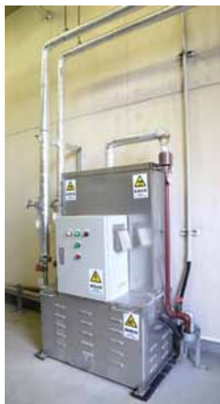
▲稼働中の開放式脱気装置
