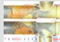
潰食が進行し漏水原因に
