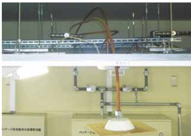
天井裏配管の様子。施工性に優れた銅管が使用されている。
