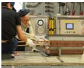
工程③ U字銅管をフィンの穴に通し、銅 管を拡管にすることにより、フィ ンを密着させる
