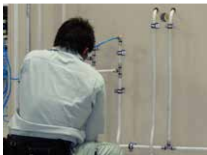
被覆銅管、裸銅管など様々な管材を使用
