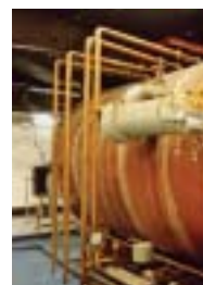
ホテル内給水・給湯はすべて銅管
