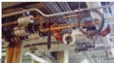
地下鉄駅舎の銅配管
