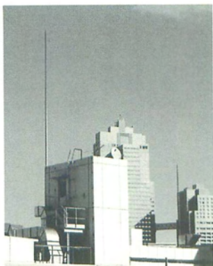
ビル屋上に設置された避雷針
