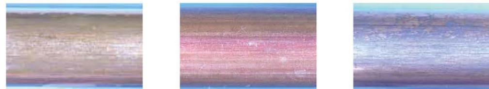
写真 変色した銅管の例
