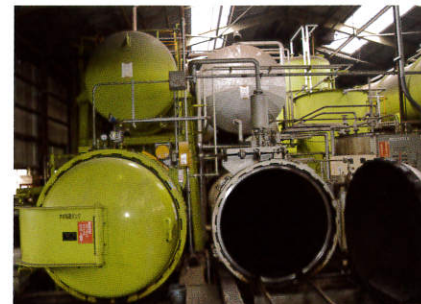
加压注入タンクの上には、銅化合物の入った薬剤タンクがある
