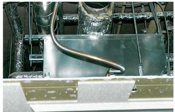
▲スプリンクラー巻出し配管(銅管)は損傷なし(神鋼病院)
