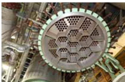
▲宮古製糖(株)の城辺工場のジュースヒーター
