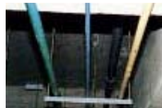
医療ガス用銅配管
