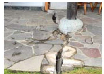
断層に沿って地割れが起き、Y氏宅を巻き込んだ
