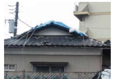
地震で多くの瓦屋根が被害にあった
