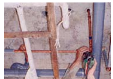
現在、配管修理を行うアパート。鉄管から銅管に切り換えた
