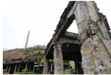
いまや製錬所のコンクリート柱は朽ちて草生している
