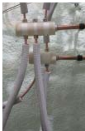
ヘッダー部配管
