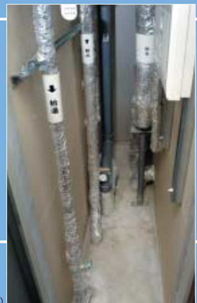
選管の定流量弁(手前下)
