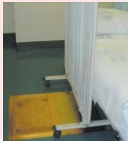
ベッド下の床に敷設された銅板
