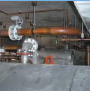
貯湯槽上部に設置された気水分離管(B)
