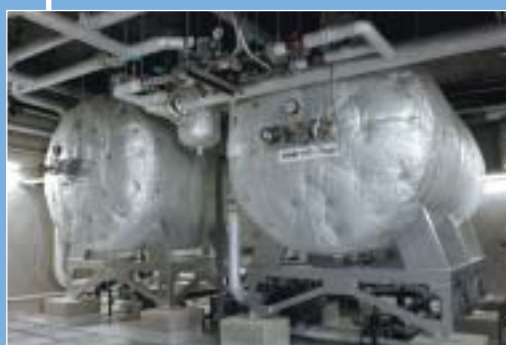
屋上熱源機械室(保温後)
