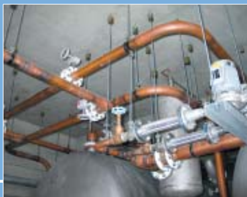
屋上熱源機械室銅配管
