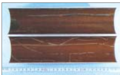
管内面スケール付着状況
